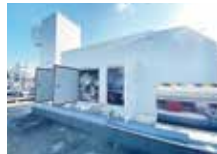
非常用発電機
